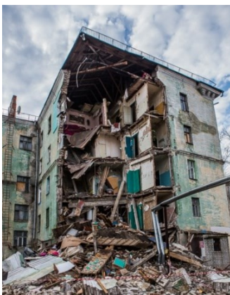
Рис. 2. Разрушение части жилого дома
