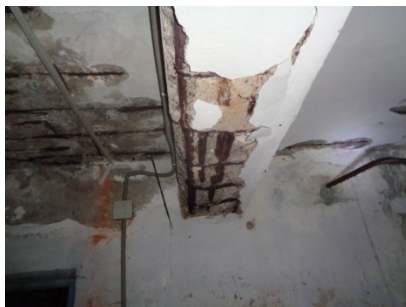
Рис. 2. Коррозия и оголение арматуры в монолитных балке и плите обследованного перекрытия
