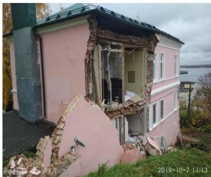
Рис. 1. Разрушение стены жилого дома
