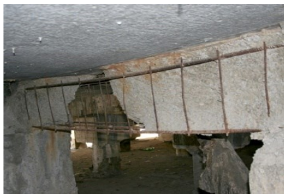
Рис.1. Поврежденные сваи г.Якутск
