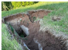
Рис. 3. Промоина на низовом откосе плотины
