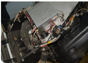
Рис. 2. Изображения установленного оборудования для ЭИМ
