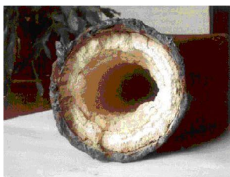
Подающая труба системы теплоснабжения
