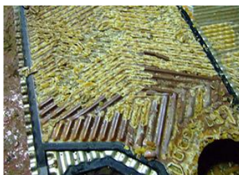
Элемент пластинчатого теплообменника с накипью
